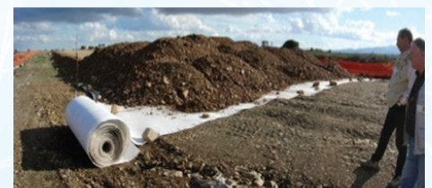
在鐵路路堤基底部安裝排水用土工複合材料。在此情況下，橫跨整個路堤安裝 GCD
