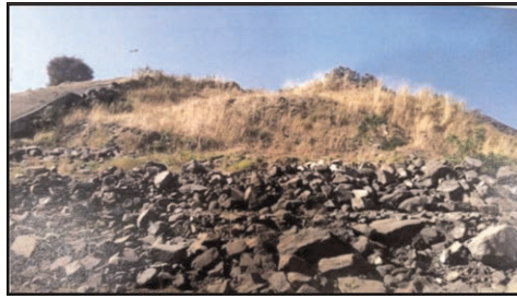
Figure 3. Distressed divide bund (Kapadia 2022).
