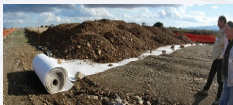
Τοποθέτηση γεωσύνθετου αποστράγγισης στη βάση του σιδηροδρομικού επιχώματος. Σε αυτή την περίπτωση το GCD τοποθετείται κατά μήκος του επιχώματος
