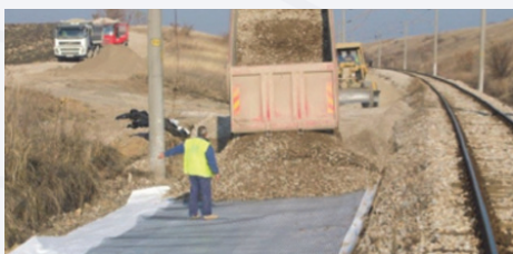
Γεωσύνθετο γεωυφάσματος – γεωπλέγματος τοποθετημένο απευθείας επί του μαλακού εδάφους για διαχωρισμό, φίλτρο και σταθεροποίηση
