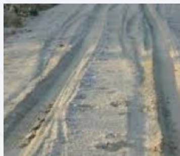
Αστοχία λόγω επιβολής φορτίων κυκλοφορίας και τροχαυλάκωση
