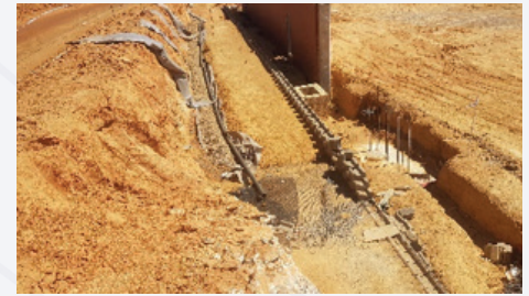
Υπόγεια αποστράγγιση ανάντη τμήματος ΤΟΕ
