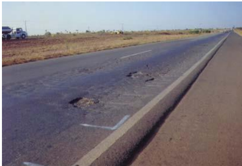
Sự phá hủy ở mặt đường thông thường
