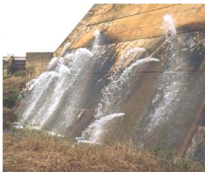
Fuites à travers un barrage *
