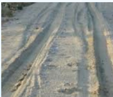
Fallas y surcos inducidos por la carga de tráfico
