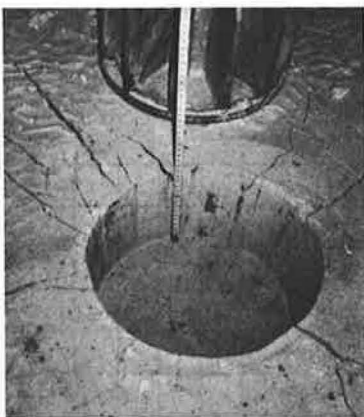
Fig. 7 : Témoin 30 cm après poinçonnement
