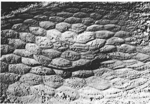
Fig. 11 : Armater après poinçonnement
