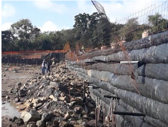
Figura 3. Imágenes de capas deformadas al retirar las formaletas de madera.
