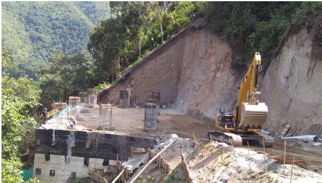
Figura 11. Instalación Pilotes a través de los Muros en Suelo Reforzado del Pente 20.
