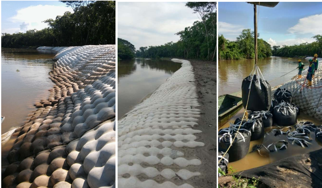
Ilustración 10: Estructura de control de erosión en Caño San Silvestre.
