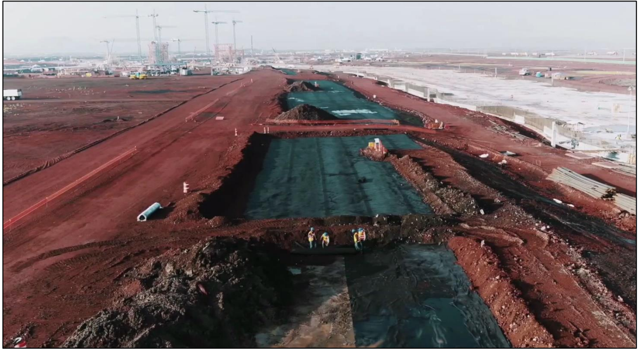
Figura 3. Instalación de 11,47 km 2 de geotextiles no tejidos y geomallas multiaxiales de polipropileno (GRUPO TDM, 2018)
