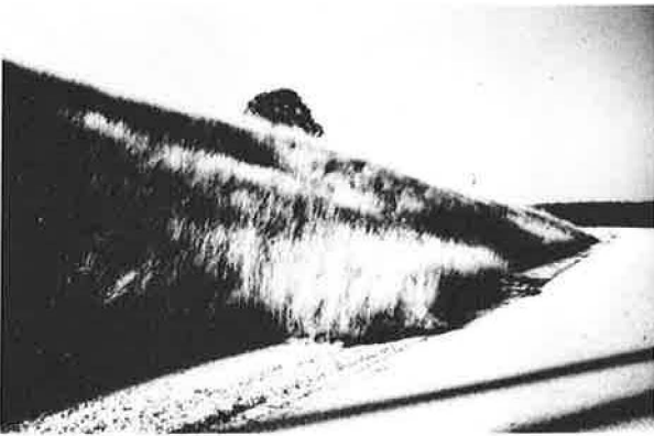
PHOTO 8 : La terre végétale mise en revêtement s'est bien végétalisée mais ne s'est pas solidarisée avec le talus et a glissé.
