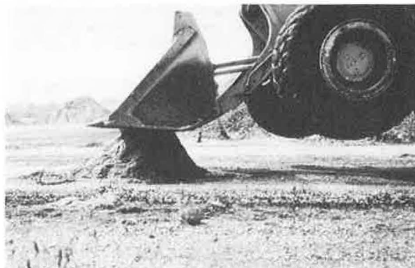
Figure 3 - Charge exercée sur un tas traité à faible dosage. La pente reste stable.
